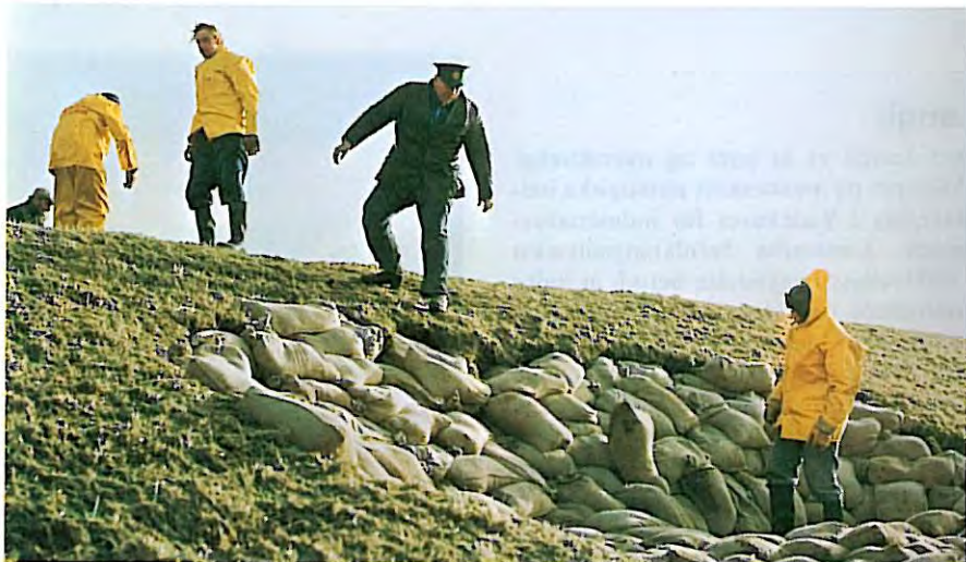
Digeskader efter stormflod.
